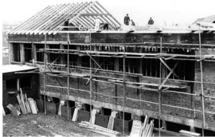
Die Waldmünchner Schulturnhalle im Rohbau. Arbeiter der Zimmerei A. Weidner beim Erstellen des Dachstuhles.
